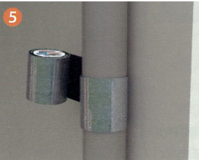
Yağmur tahliye sistemlerinde
