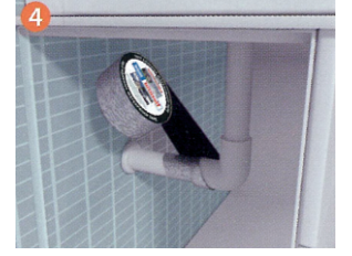
Lavabo çıkış borularında
